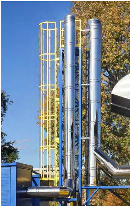
Mała elektrociepłownia, Racibórz
